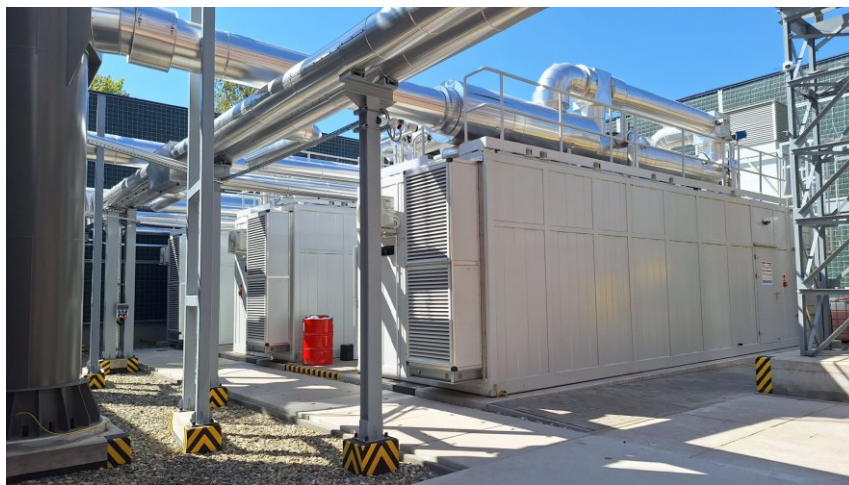
Instalacja kogeneracyjna Dalkii Polska Energia w Katowicach
